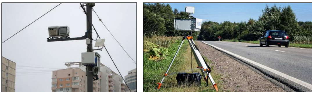
Рисунок 39 – Примеры установки комплексов фотовидеofиксации
