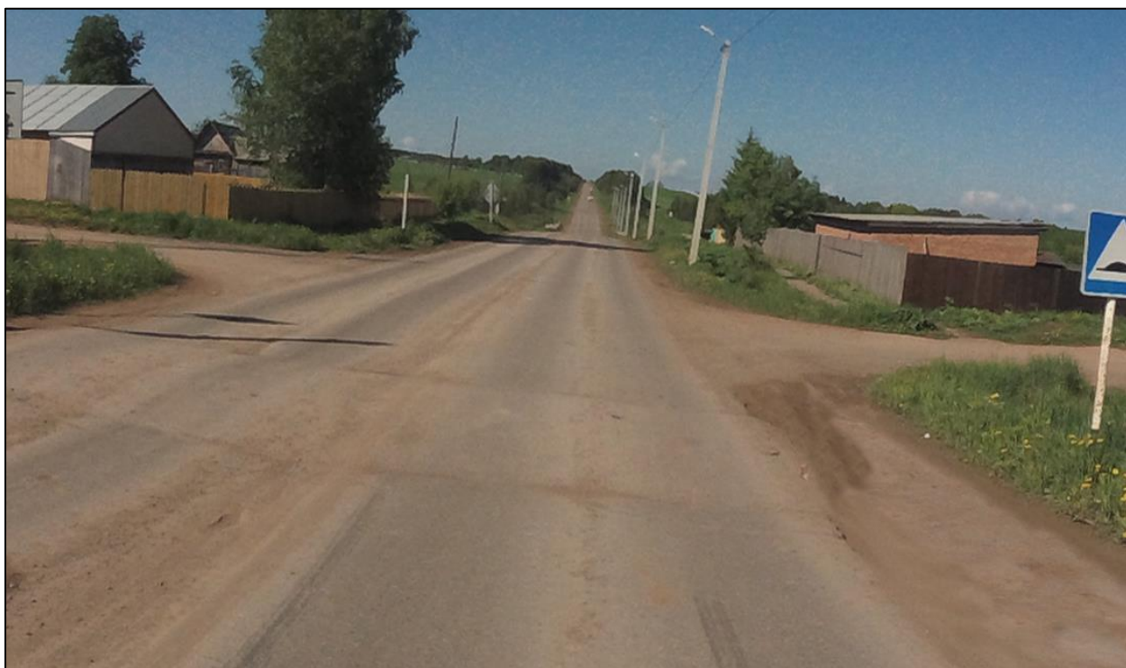
Рисунок 1.7.8 – Пример эксплуатационного состояния ИН неровности монолитной конструкции, расположенных по ул. Центральная, д. Ивукова
