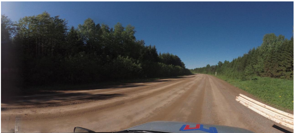
Рисунок 1.4.4 – Состояние дорожного покрытия а/д «г. Кудымкар - с. Верх-Иньва» на момент обследования
