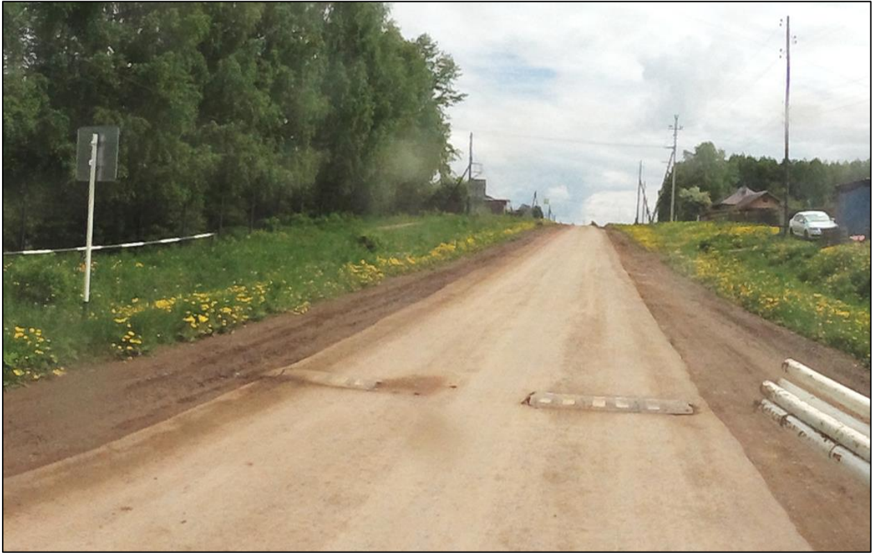
Рисунок 1.7.9 – Пример неудовлетворительного состояния ИН сборно-разборной конструкции, расположенной в с. Белоево по ул. Комсомольская
