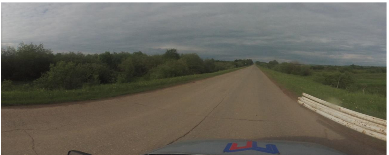
Рисунок 1.4.12 – Состояние дорожного покрытия а/д «с. Егва – д. Ваганова» на момент обследования
