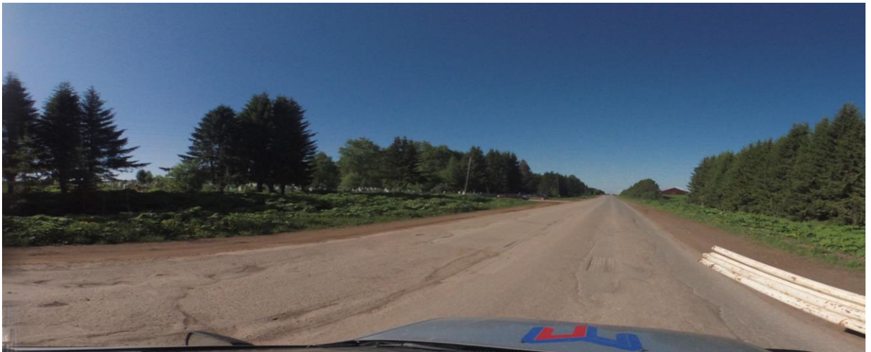
Рисунок 1.4.3 – Состояние дорожного покрытия а/д «г. Кудымкар - с. Верх-Иньва» на момент обследования
