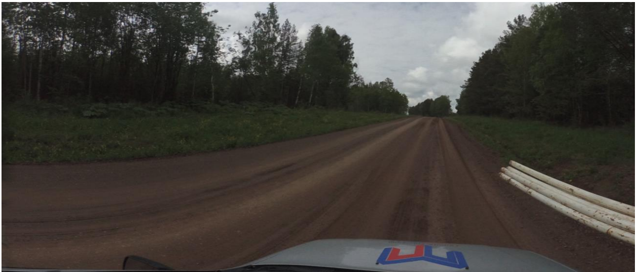
Рисунок 1.4.8 – Состояние дорожного покрытия а/д «с. Белоево – с. Кува – д. Сидорова» на момент обследования
