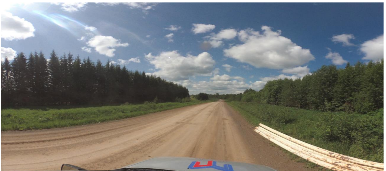
Рисунок 1.4.6 – Состояние дорожного покрытия а/д «с. Верх-Иньва – д. Демино – д. Визяй» на момент обследования
