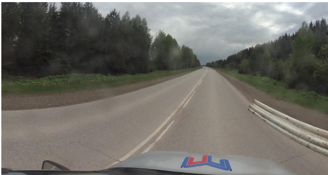
Рисунок 1.4.2 – Состояние дорожного покрытия а/д 57 ОП РЗ 57К-0073 «г. Кудымкар – п. Гайны» на момент обследования
