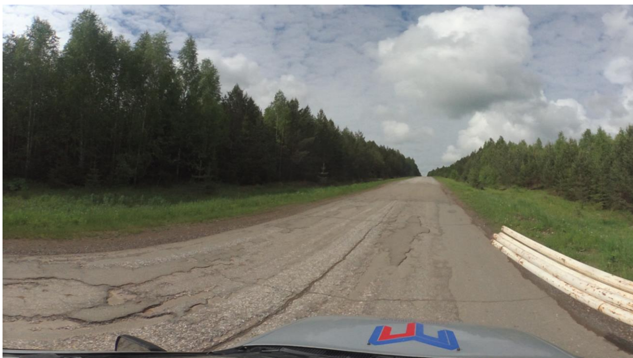
Рисунок 1.4.7 – Состояние дорожного покрытия а/д «с. Белоево – с. Кува – д. Сидорова» на момент обследования
