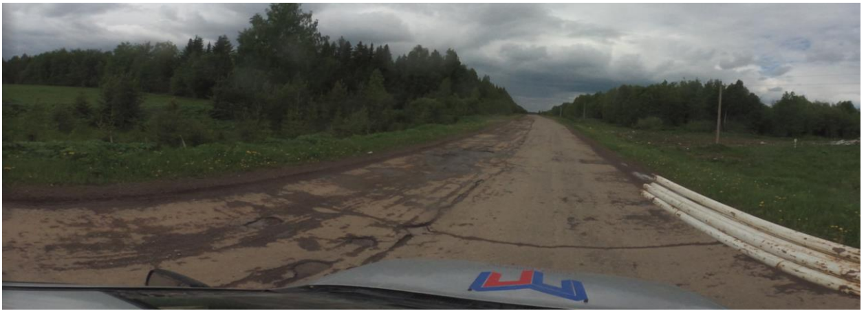
Рисунок 1.4.11 – Состояние дорожного покрытия а/д «г. Кудымкар – с. Ошиб» на момент обследования
