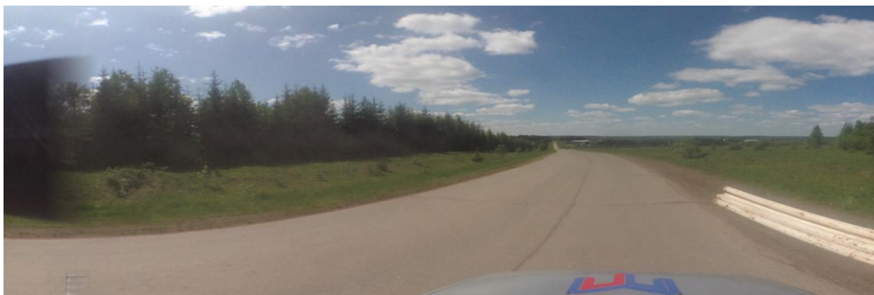
Рисунок 1.4.10 – Состояние дорожного покрытия а/д «д. Сидоршор – с. Верх Юсьва – д. Бормотова» на момент обследования
